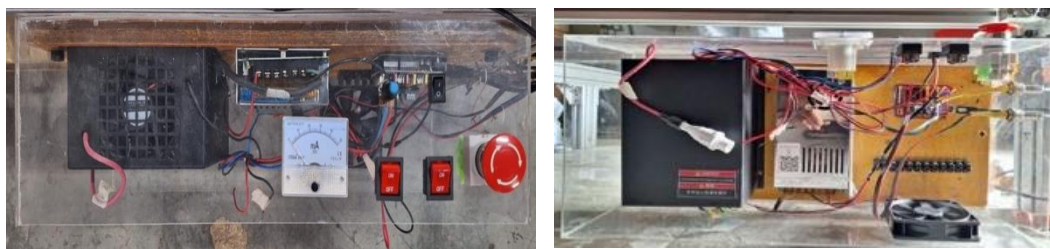
Gambar 2. Panel sistem kontroler
